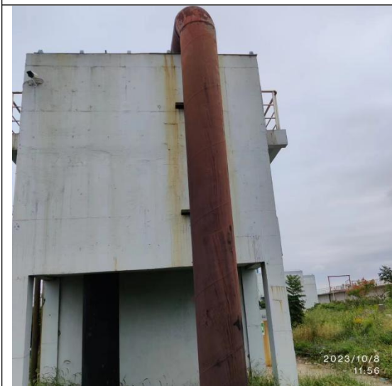
废气收集管道
