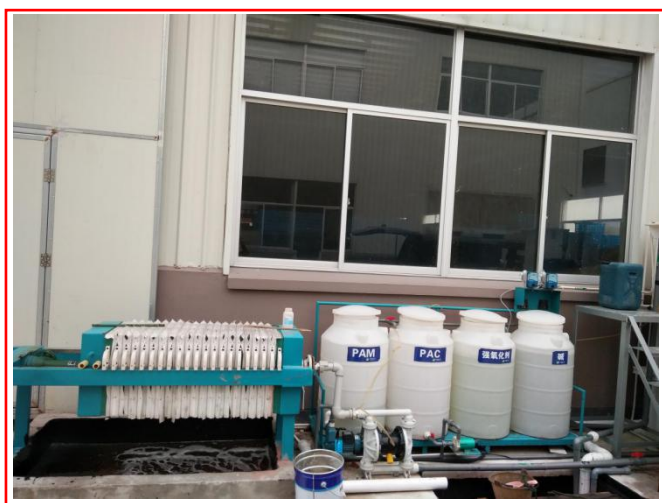
废水处理设施
