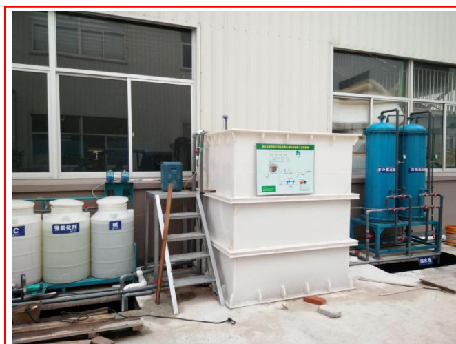
废水处理设施
