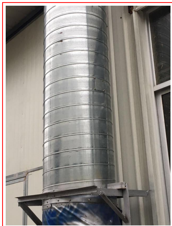
喷漆排气筒规范检测口
