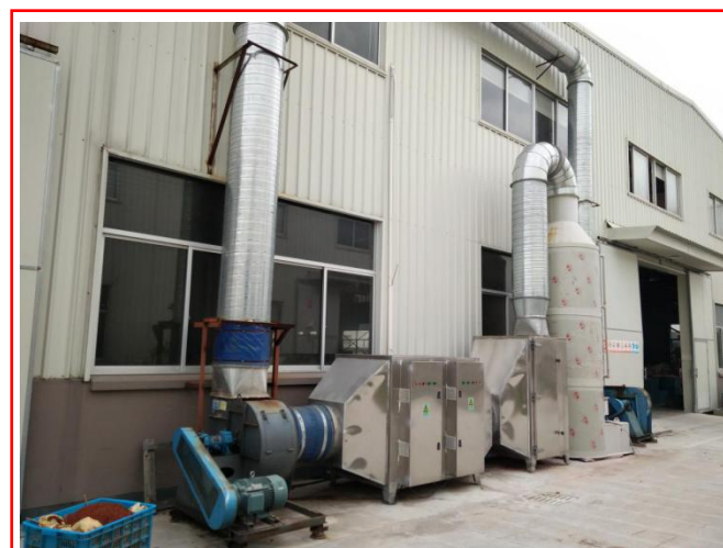
废气处理设施
